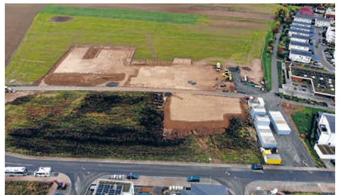
Baufeld für die neue Grundschule im Limespark gegenüber vom Kindergarten am Betonweg Foto: Stadt Öhringen
